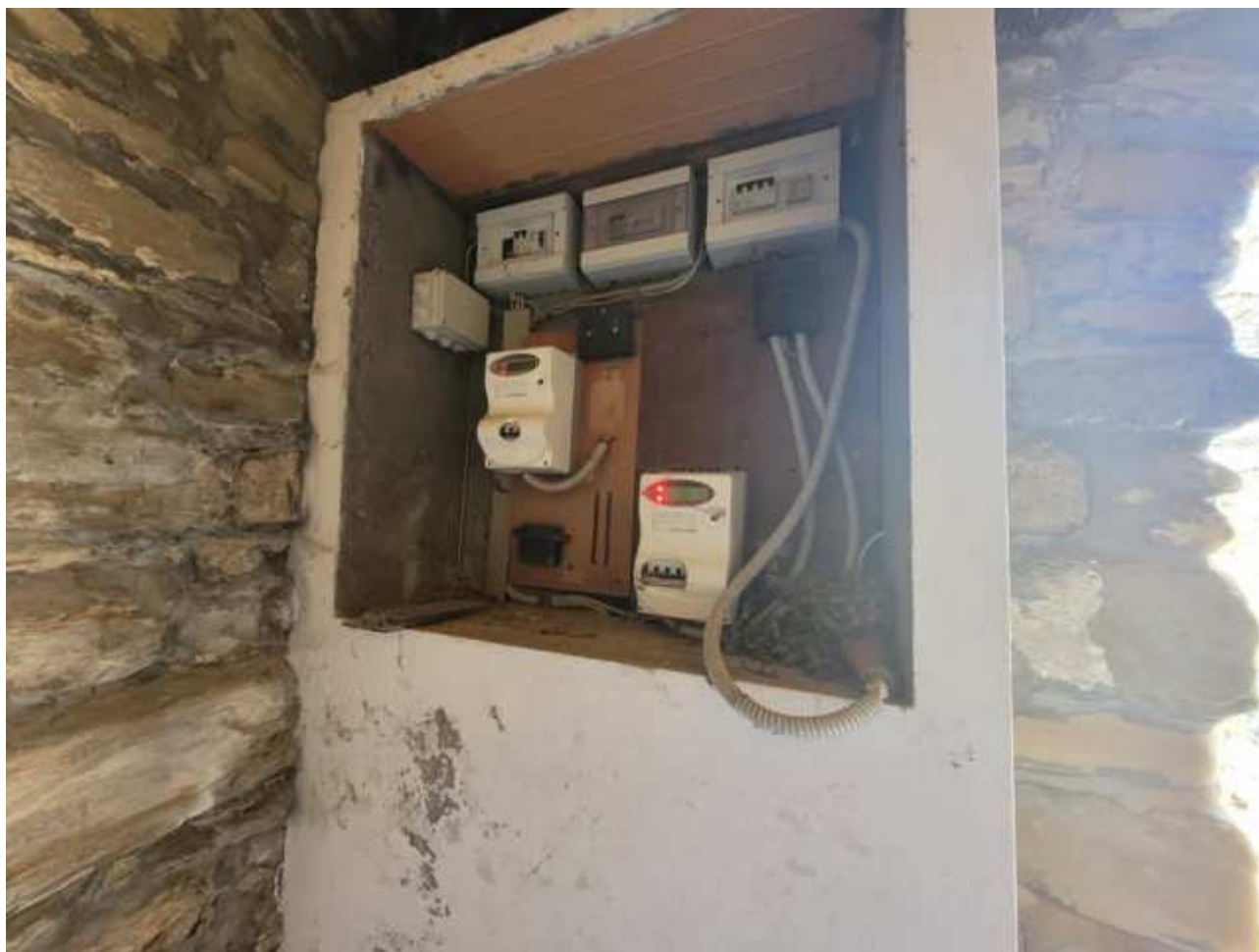
Foto n. 36 – vano contatori fabbricato rurale
