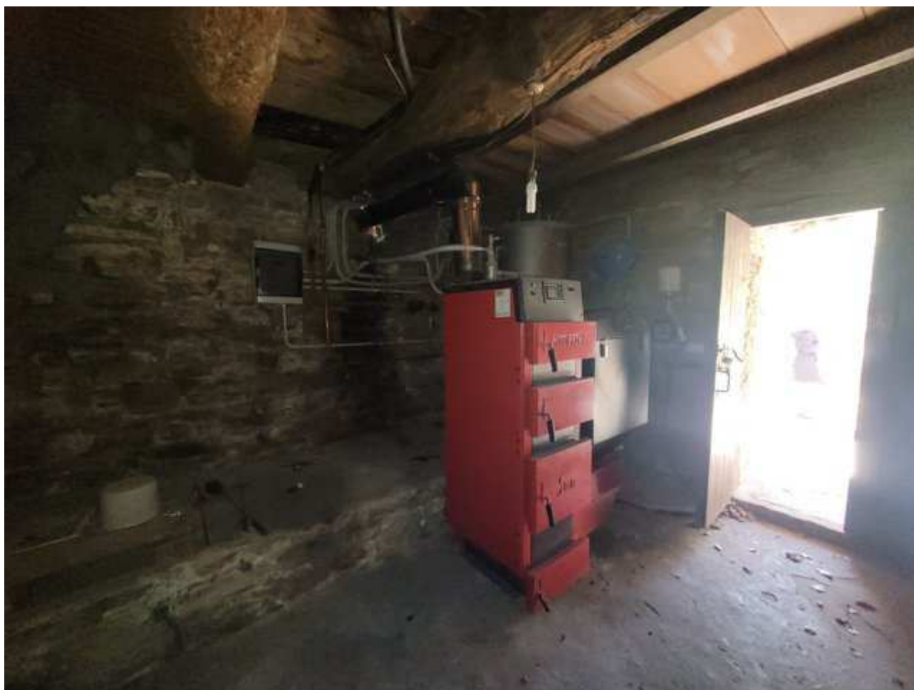
Foto n. 35 – caldaia interno fabbricato rurale
